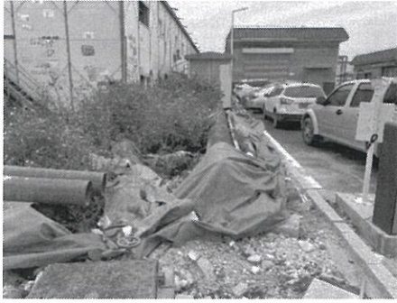
加压设施安装位置
